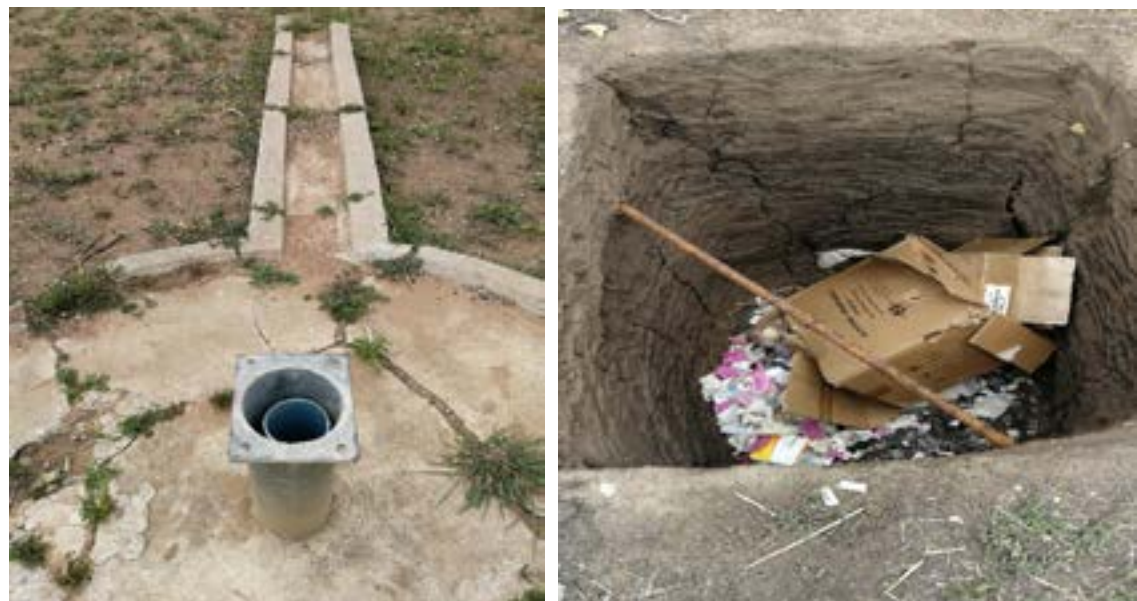
Figura 8: Estrutura de fontenário inoperacional; Aterro sanitário do centro de saúde de Mepoche
