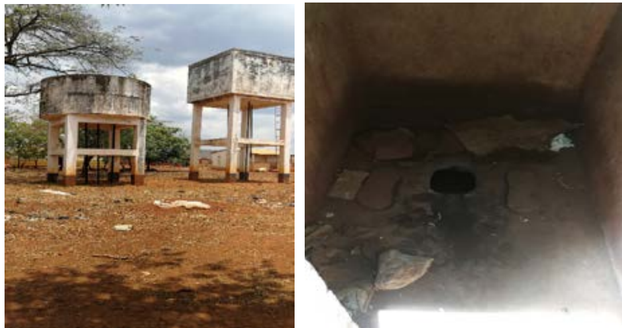
Figura 6: Torres de sistema de abastecimento de água no recinto hospitalar, inoperacionais Casa de banho para utentes da maternidade
