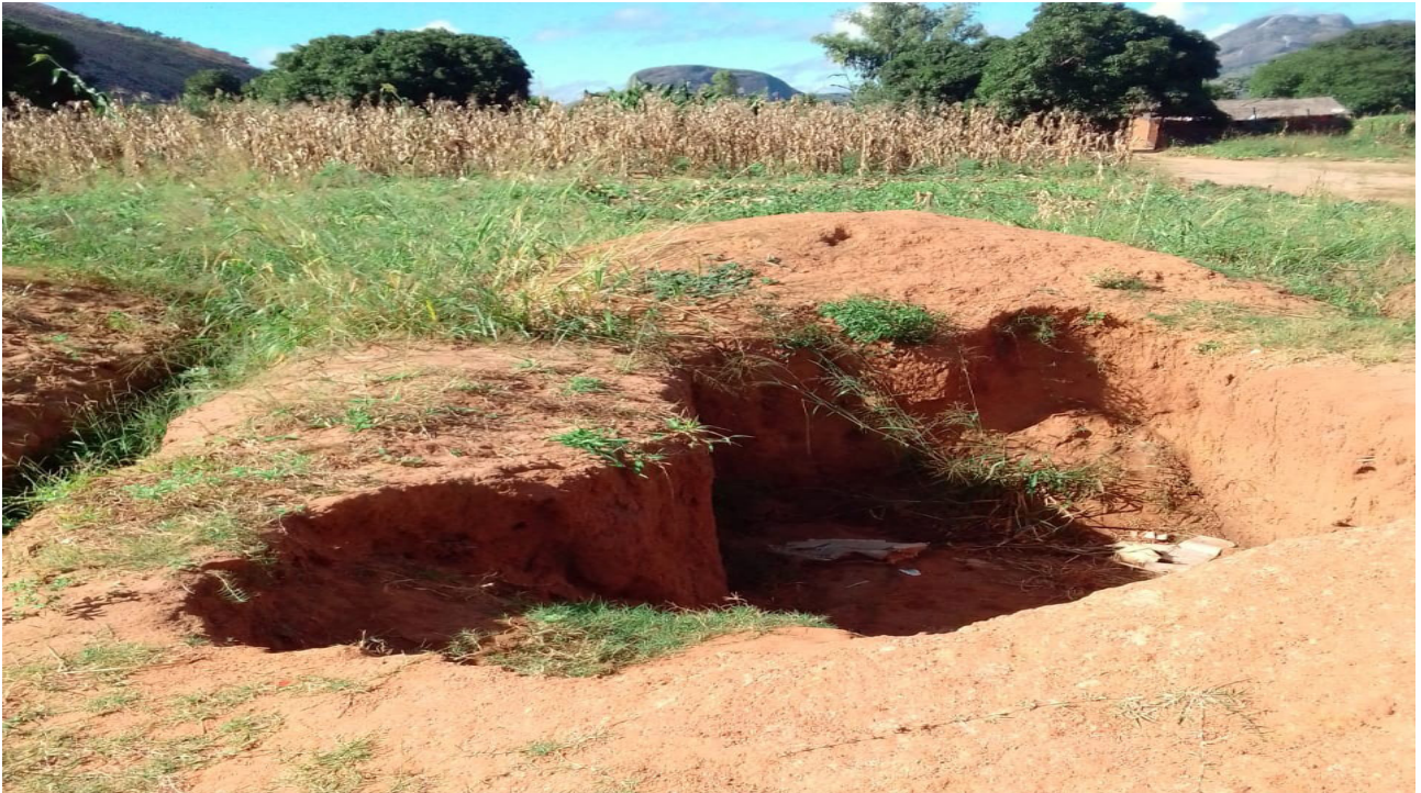
Figura 1: Escavações para início de obras – Escola Secundária de Niosse- Distrito de Malema
