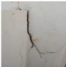
Casas de banho com rachas
