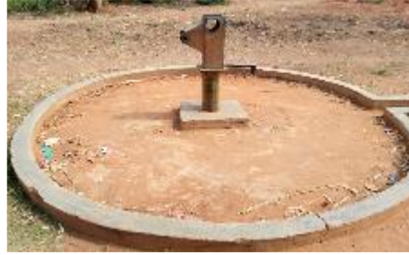
Imagem 2: furo de agua avariado
