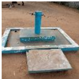
1 mini sistema de agua avariado
