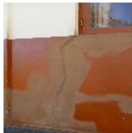
Racha nas paredes
