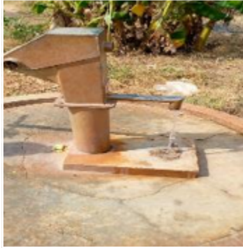
Furo de água em funcionamento
