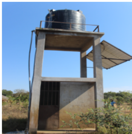
Pequeno Sistema de Abastecimento de Água
