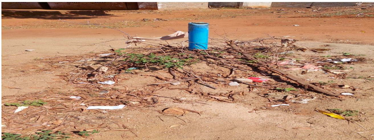
Imagem 20: construção de sistema de abastecimento de água abandonado pelo empreiteiro
