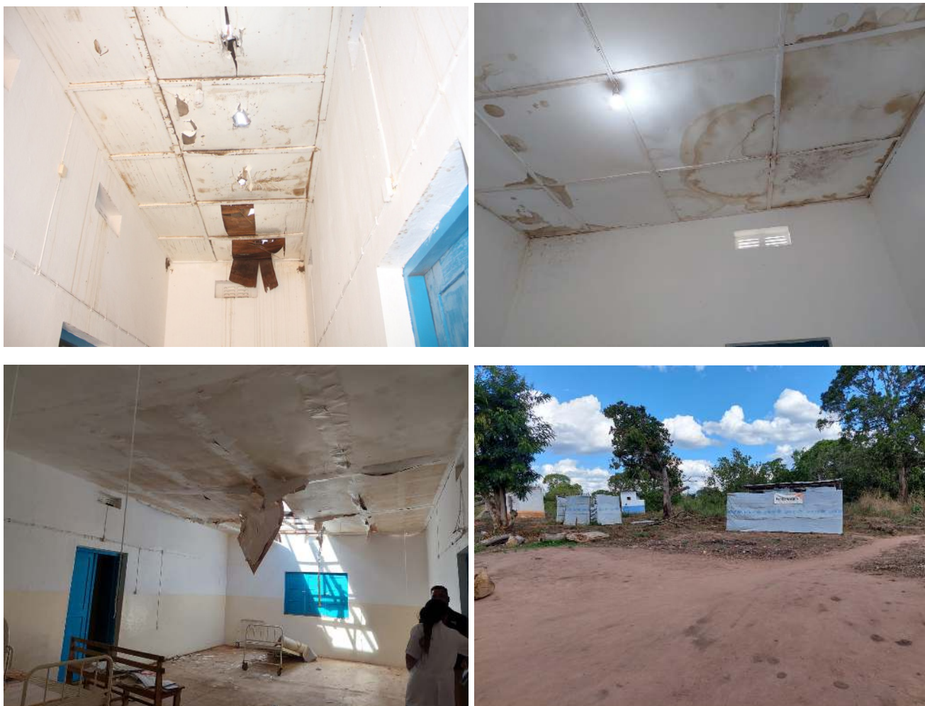
Imagem 37: Estado das infraestruturas no Centro de saúde de Corane
