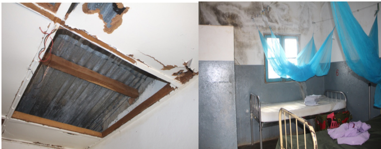
Imagem 30: condições das infraestruturas do Hospital Rural de Ribáuè
