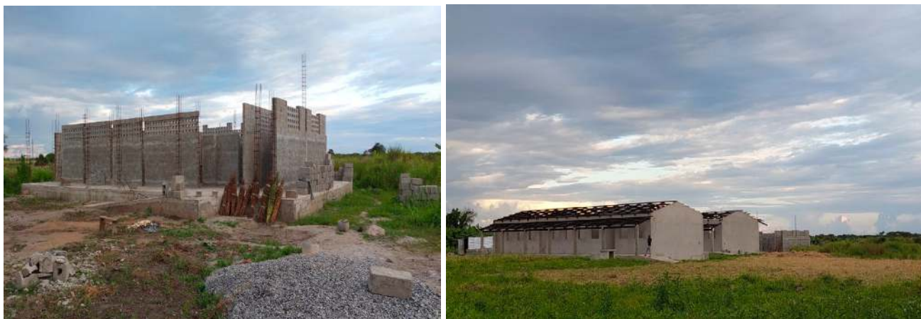
Imagem 9: Obras paralisadas de sanitários e salas de aulas em construção na EPC 1 e 2 grau de mutuo
