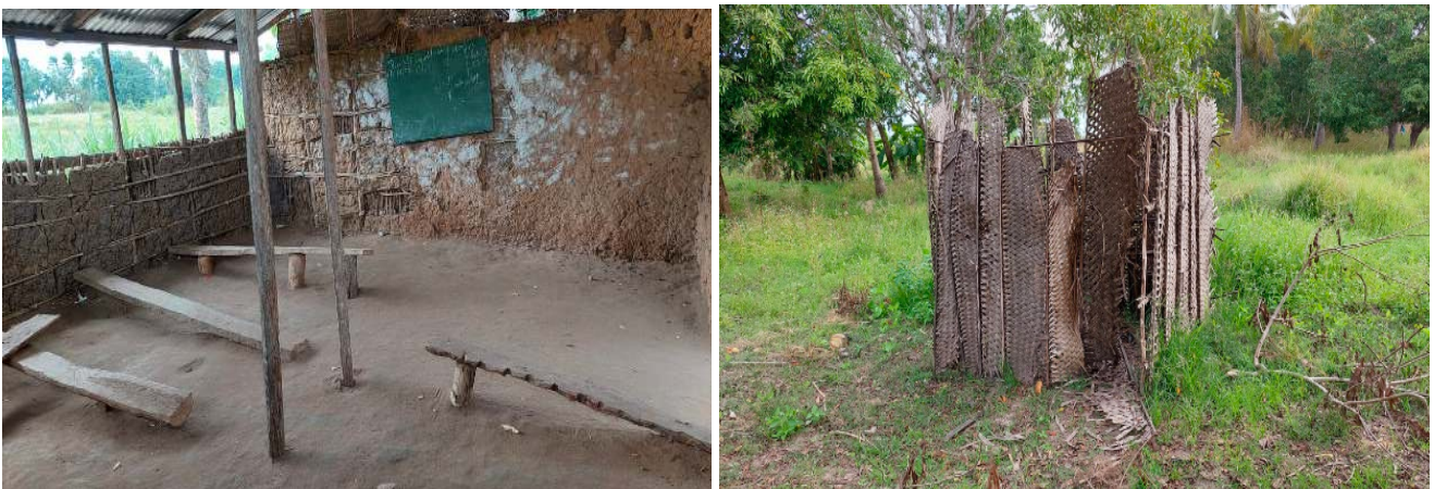
Imagem 38: sanitário e salas de aulas precárias usadas na EPC de Mitulane
