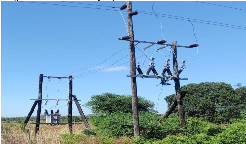
Imagem 7: Sistema de electrificação avariado na localidade de Chitambo.
