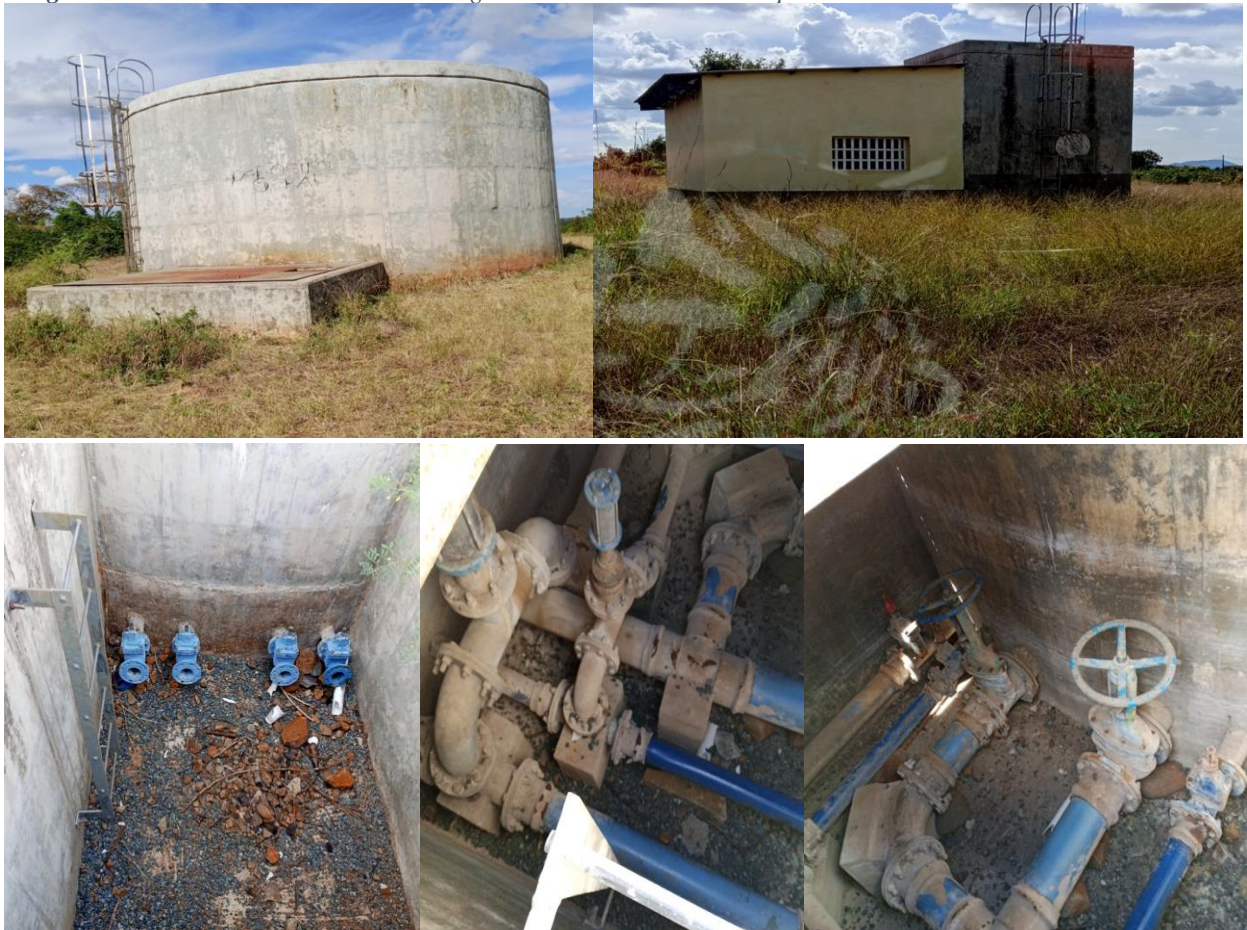
Imagem 15: Sistema de abastecimento de água abandonado construída pela Vale.
