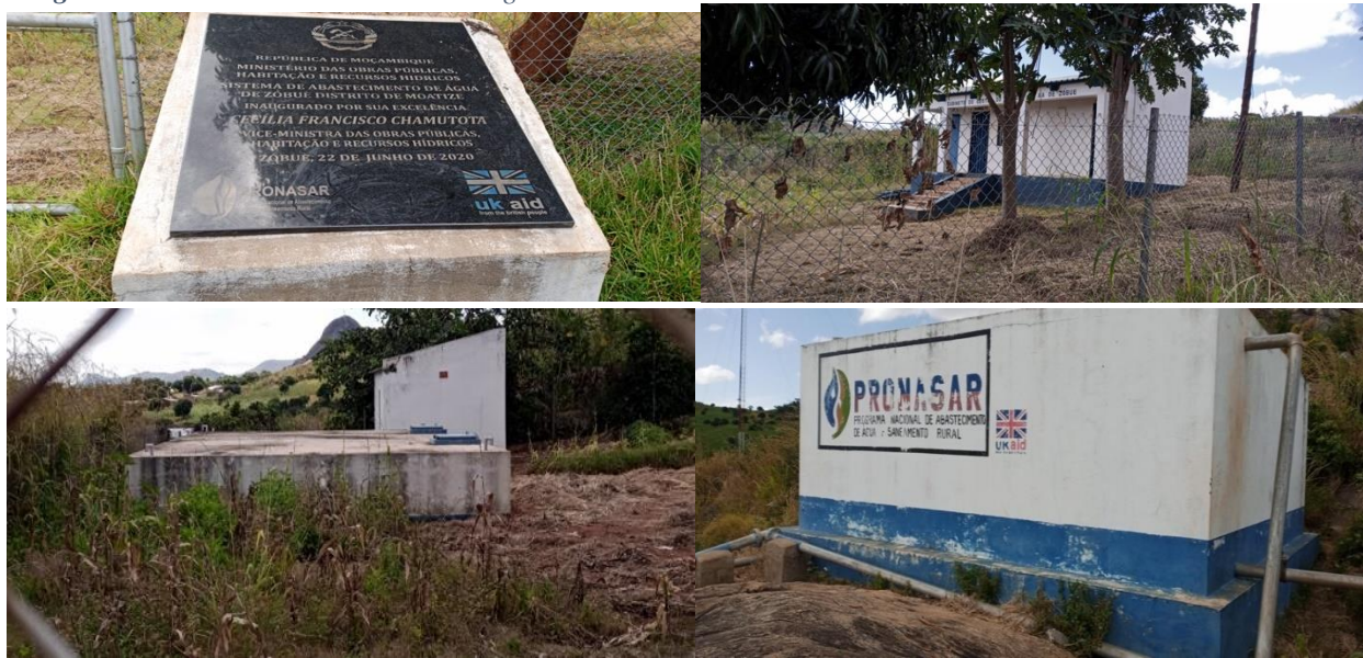
Imagem 2: Sistema de abastecimento de água avariado.
