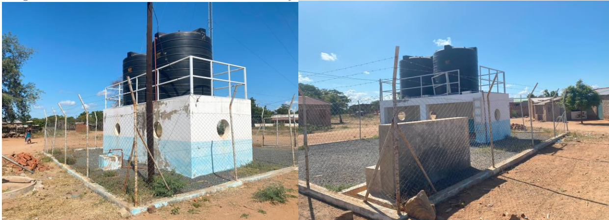
Imagem 9: Sistema avariado construído em 2019 com fundos dos 2,75%.
