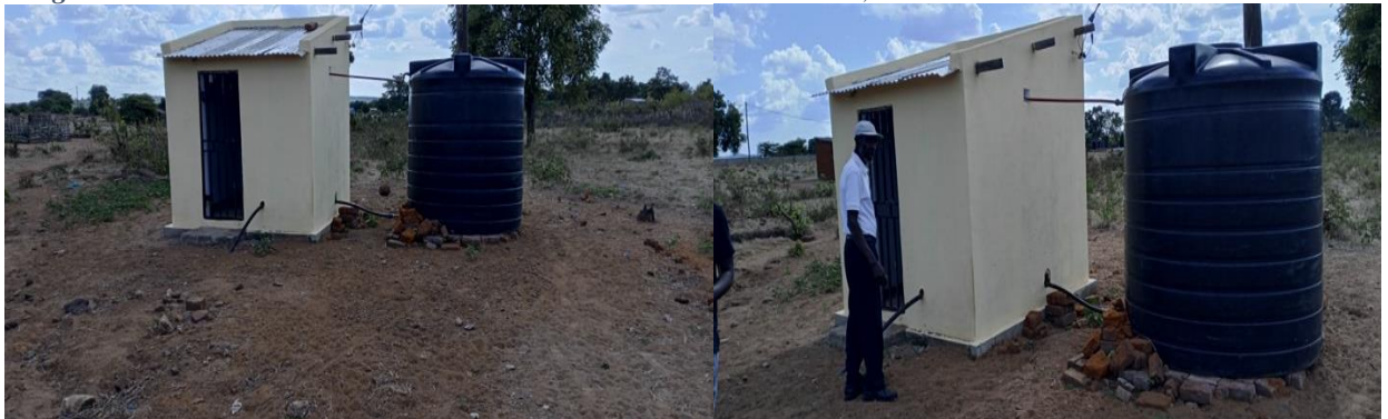
Imagem 18: Sistema de abastecimento furo construído com fundos do 2,75%.
