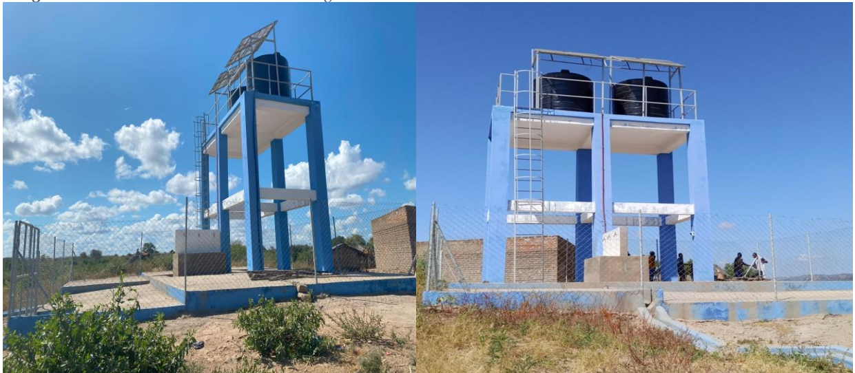
Imagem 10: Sistema de abastecimento de água de Nhambalualo avariado.
