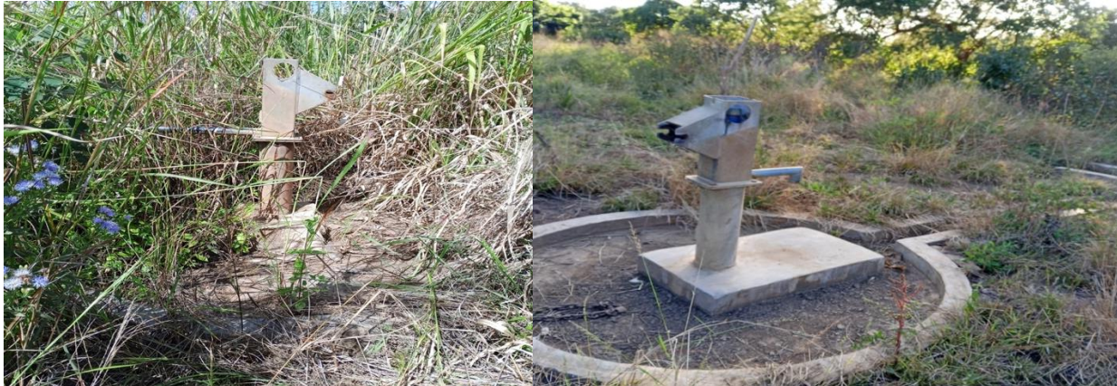
Imagem 4: Furos de água abandonados na localidade de Zóbuè.
